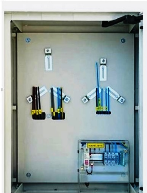
Obr. 3 Elektromerové rozvádzače sú pripravené na osadenie elektromera a hlavného ističa
