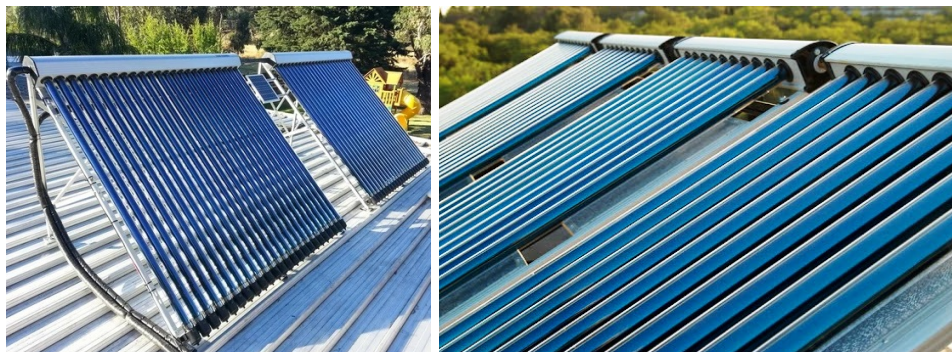
Solárne kolektory (panely)
